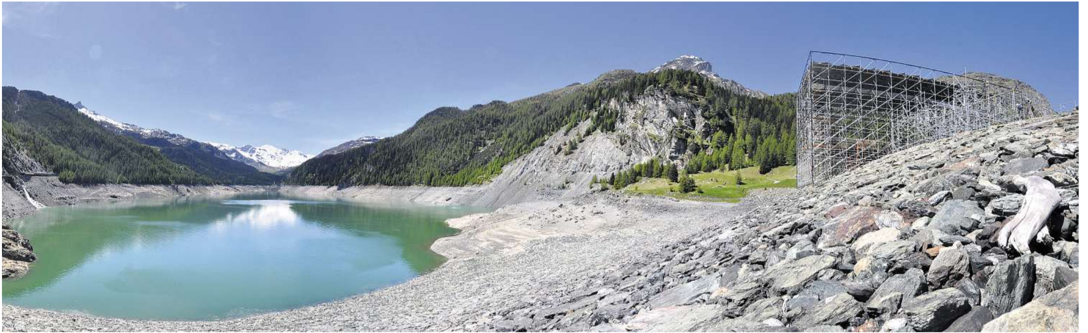
Baustelle mit Seeblick: Auf dem steinbestückten Damm am Lai da Marmorera entsteht derzeit die aufwendige Infrastruktur für Origen's Neuinterpretation der Geschichte um Noah und seine Arche.
